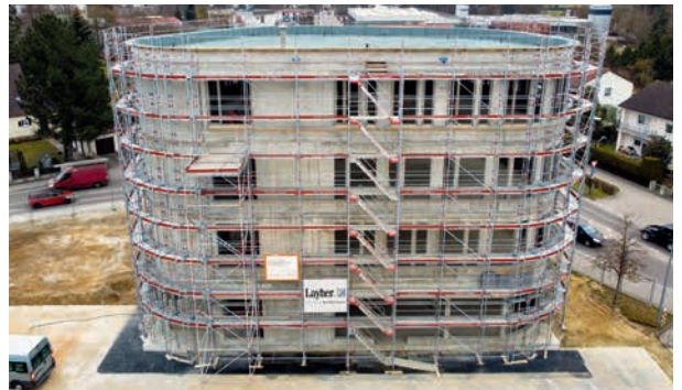
Rundrüstung mit integrierter Podesttreppe und Materialabsetzbühne
